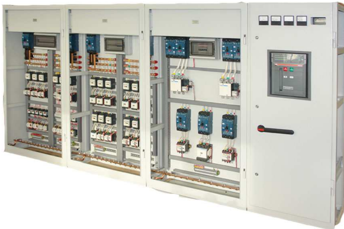
Рисунок 4 – Шкафы автоматики и телемеханики
