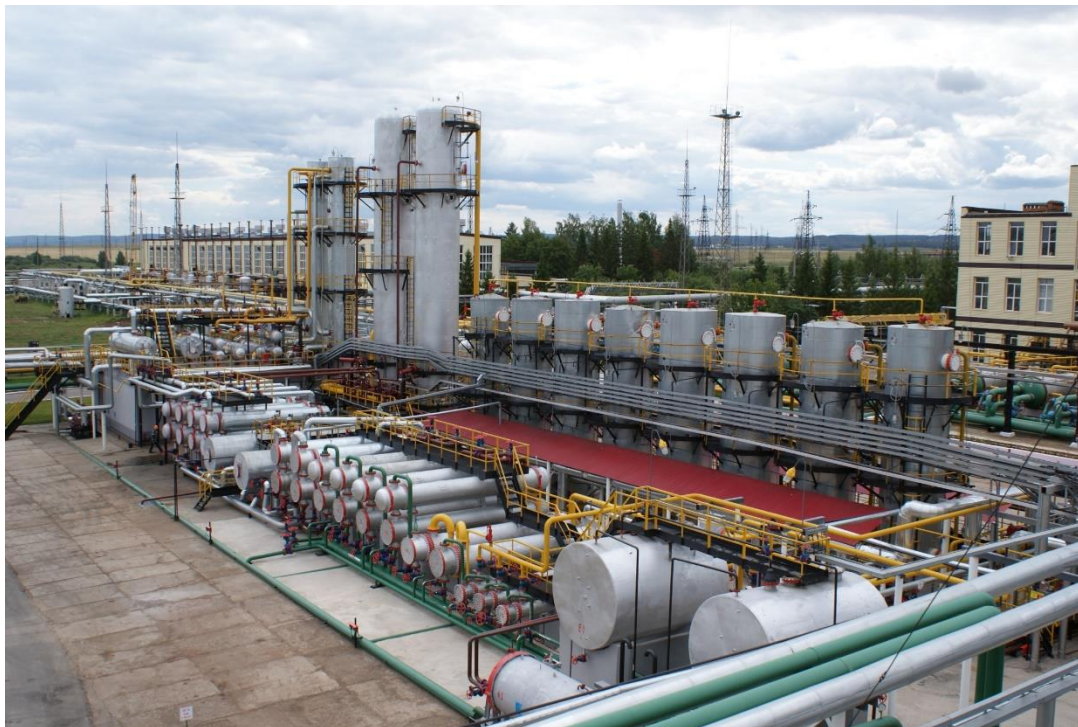
Рисунок 5 – Установка осушки и очистки газа V-ой очереди
